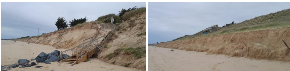
Figure 13 - Plage du Peu Ragot (à gauche) et plage des Anneries au niveau de la batterie Herta (à droite) après le passage de la tempête Karlotta (photo prise entre le 11/03 et 20/03/2024). © Observatoire de la côte de Nouvelle-Aquitaine
