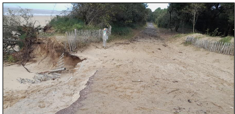
Figure 26 - Impacts de l'érosion marine sur la piste cyclable au droit des Combots (ONF)
